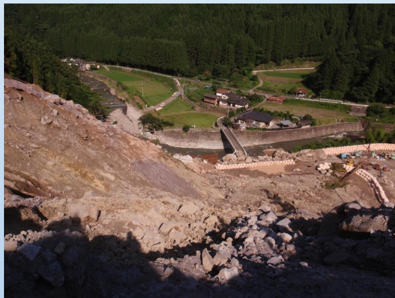
崩壊中腹から下流側（凝灰岩地盤，湧水がある）
