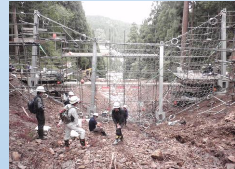
奥田洞堰堤上部に設置されたリングネット工
