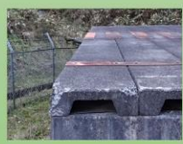
※既存の対策工（松之本団地）
