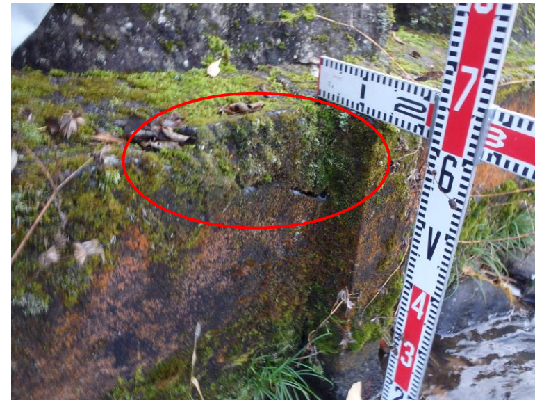
コンクリートの劣化
